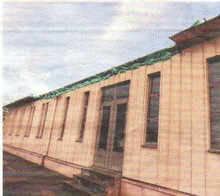
Une partie de la toiture n'a pas résisté aux vents violents.
